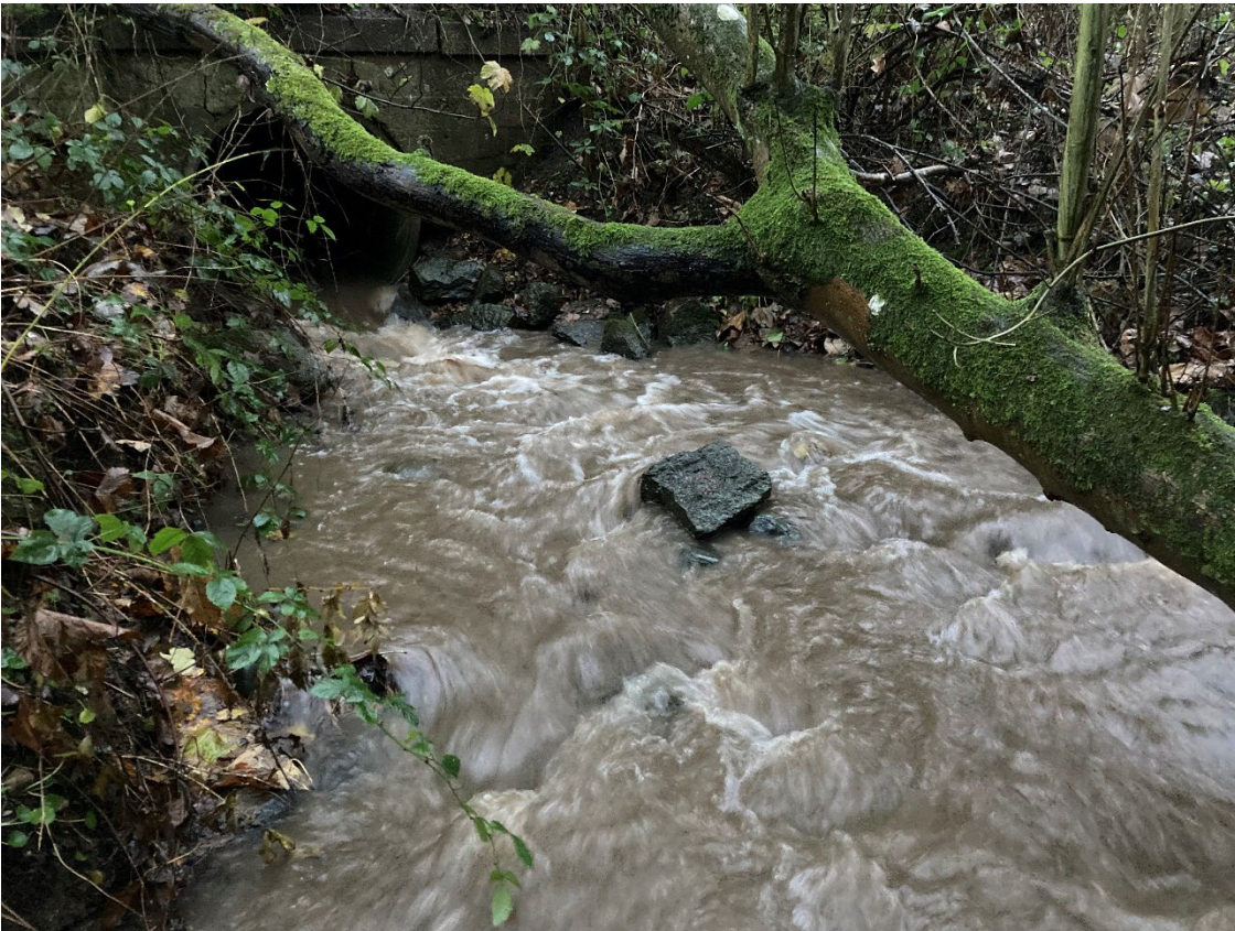
Figur 7. Store sten ved udløb fra rørledningen, december 2021
